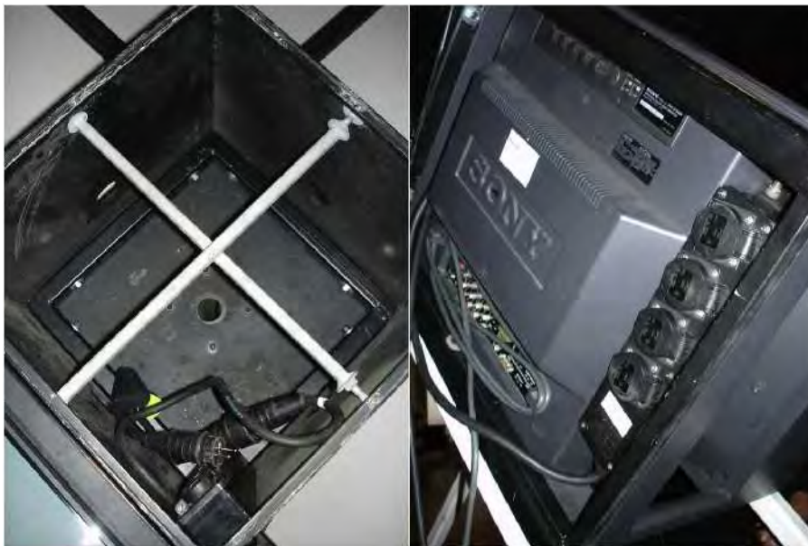
Afbeelding 15. bekabeling monitoren. L: contrastekker en interne stekkerdoos, R: externe stekkerdoos (weggewerkt in de open constructie van de monitor)
